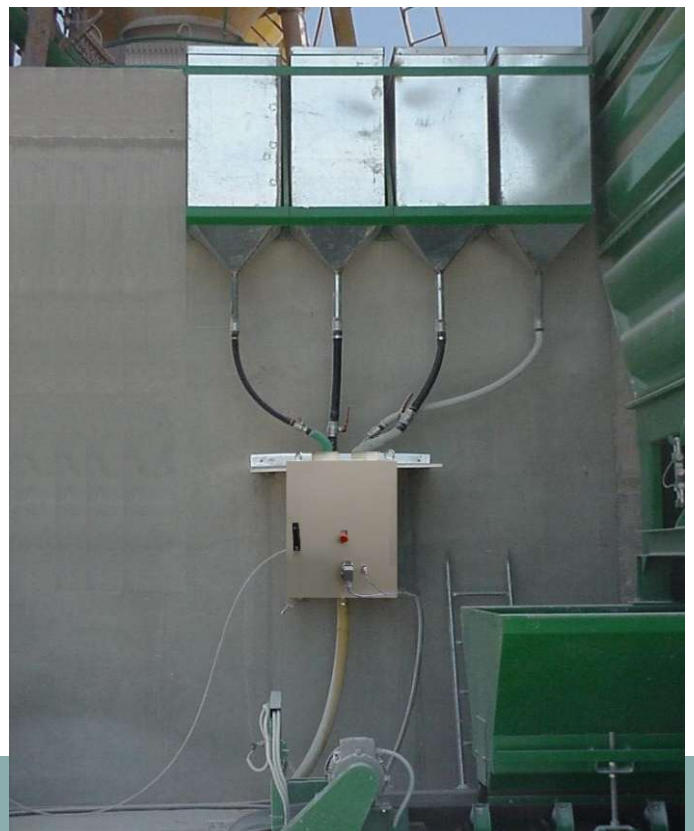
Einbausituation im Betonwerk Example in a concrete plant
