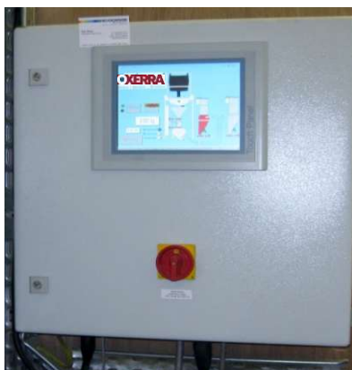
Ansicht SPS Steuerung / View of the PLC control
