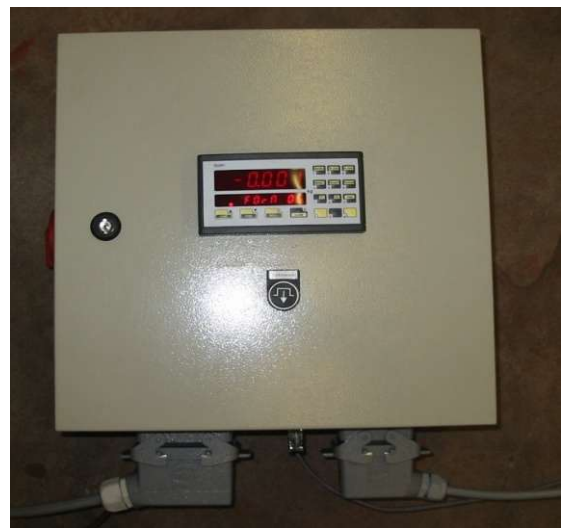
SPS Steuerung PLC control
